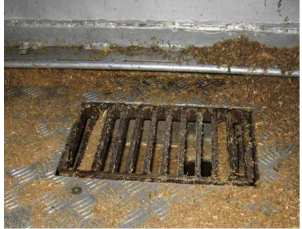
Abflussloch mit zu breiten Spalten
