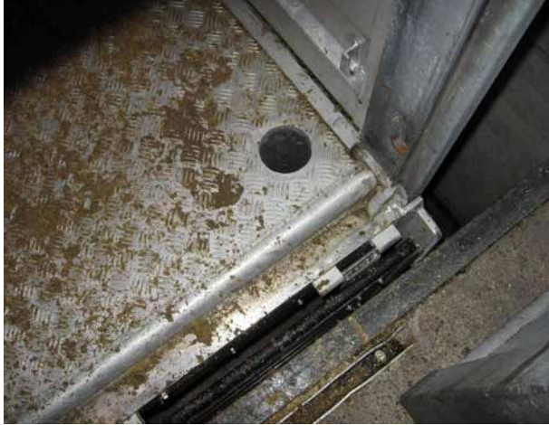
Abflussloch ohne Sicherung
